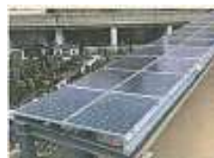
【太陽光発電設備】イメージ写真 • 太陽の光を集めて、電気をつくります。 • 電気設備工事で発電量10kWを確保します。その他はPPA事業で設置します。
