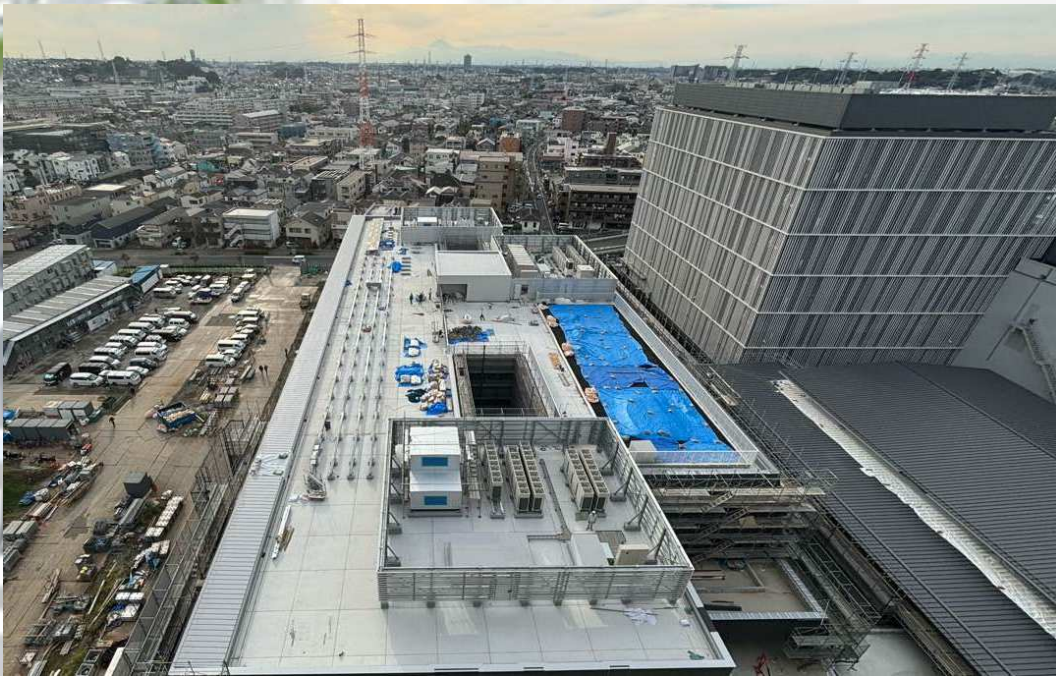
【校舎棟】屋上室外機、全熱交換器付外気処理空調機の設置状況
