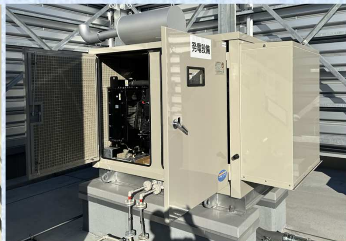
【校舎棟屋上】12月 発電機設置状況
