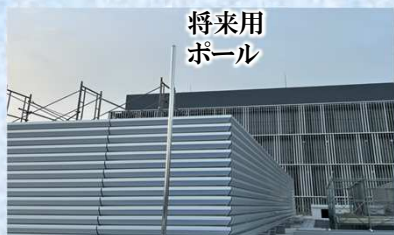
【校舎棟屋上】11月 将来防災無線用アンテナポール
