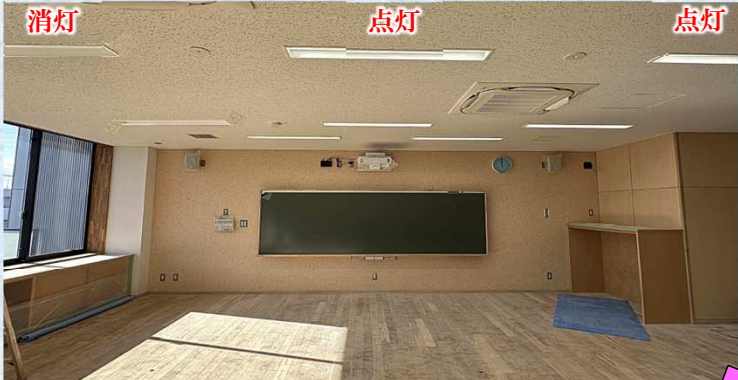
【校舎棟教室】12月 明るさセンサー設置状況
